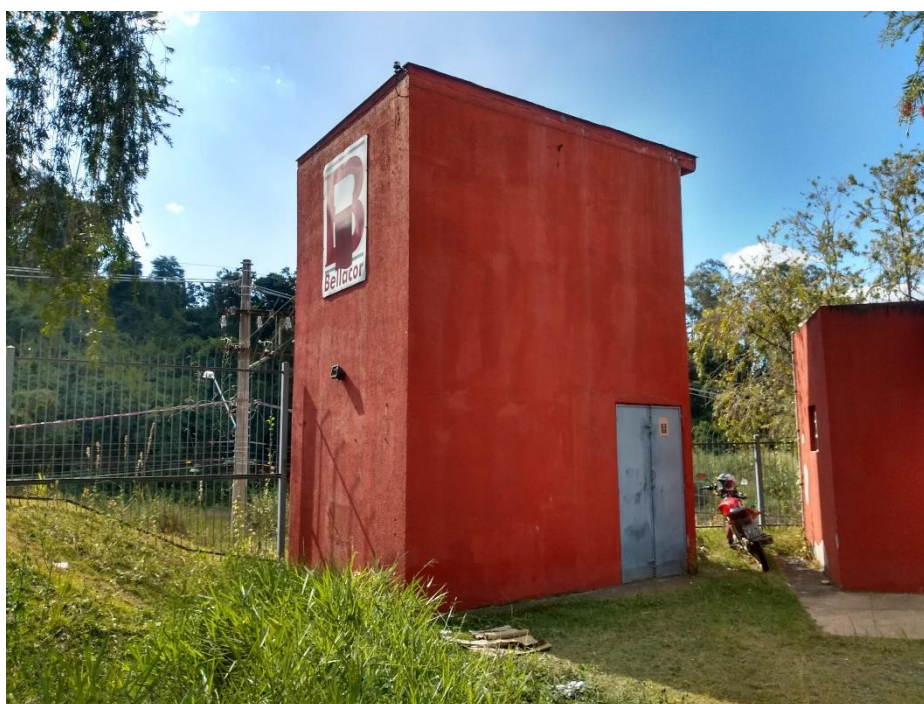
Vista da cabine de energia
