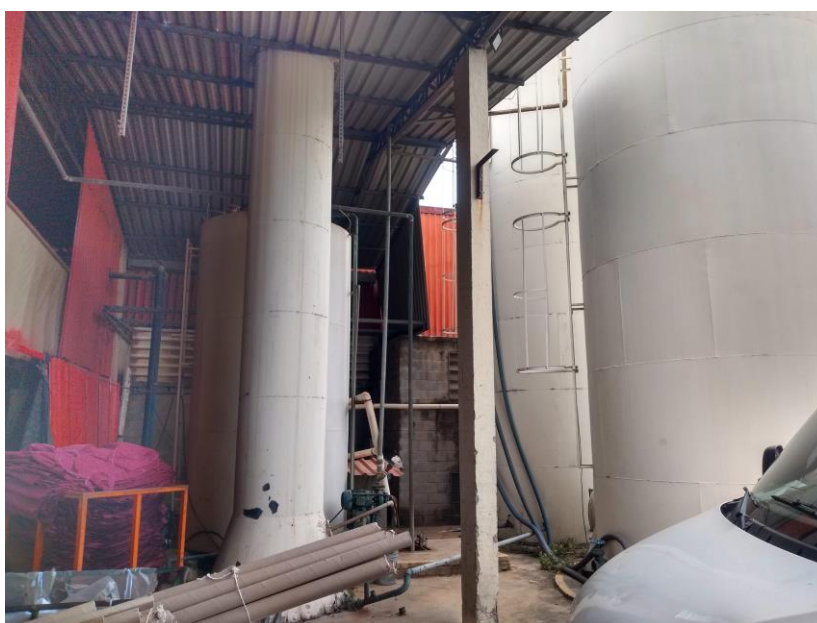
Vista dos reservatórios de água
