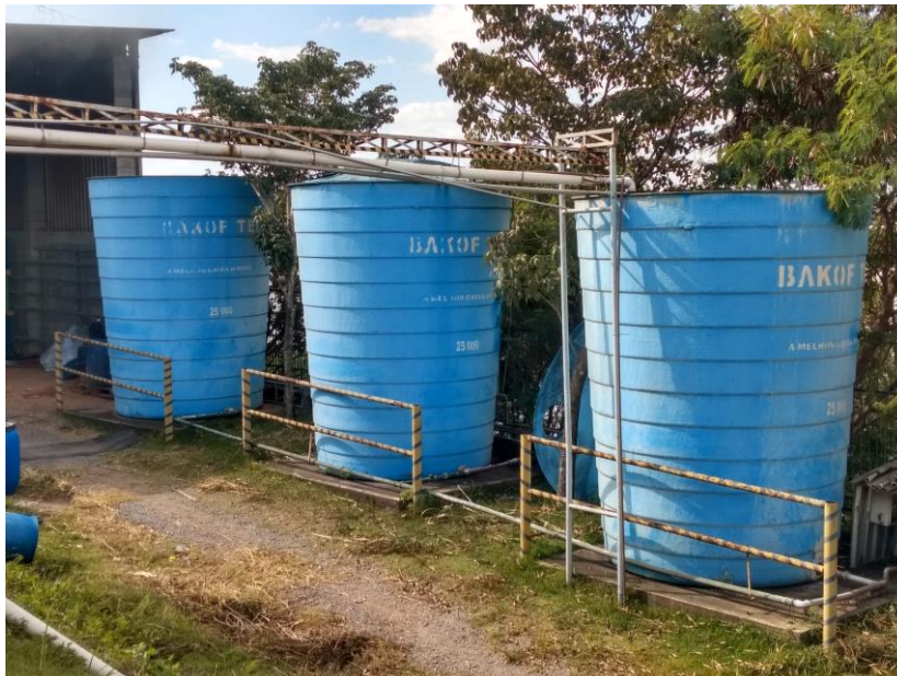
Vista dos reservatórios de água
