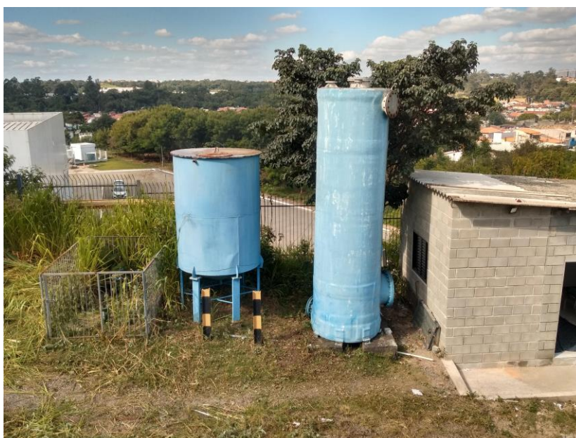
Vista dos reservatórios de água
