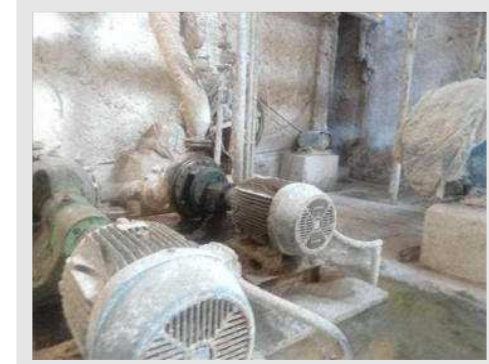
BOMBA CENTRÍFUGA MARCA IMBIL MOD 100270 COM MOTOR DE 20 CV (TANQUE DO MEIO ALVENARIA) | Item: 107 |
