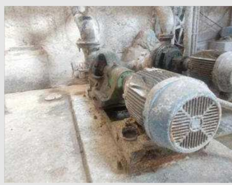
BOMBA CENTRÍFUGA MARCA IMBIL MOD 100270 COM MOTOR DE 20 CV (TANQUE DO MEIO ALVENARIA) | Item: 106 |
