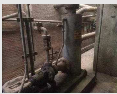
TANQUE SEPARADOR DE VACUO DIAM 70X150 CM COM BOMBA CENTRÍFUGA MARCA CAMBERRA COM MOTOR DE 2 CV | Item: 118 |
