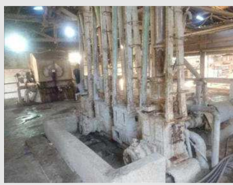
CENTRIFUGA MARCA IKMORI SISTEMA DE CONTROLE ALLEN BRADLEY COM 4 | Item: 97 |
