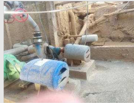
BOMBA CENTRÍFUGA MARCA IMBIL MOD ITAP 250/290 COM MOTOR DE 30 CV | Item: 84 |
