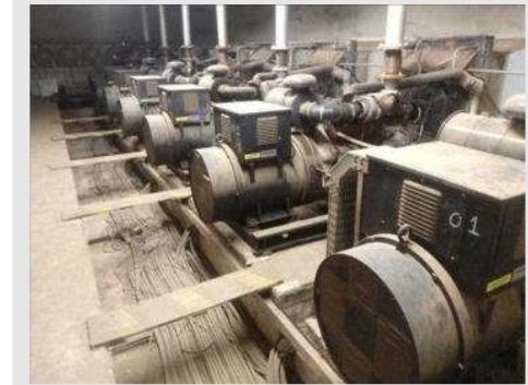
GRUPO GERADOR MARCA STEMAC POT 450 KVA | Item: 241 |
