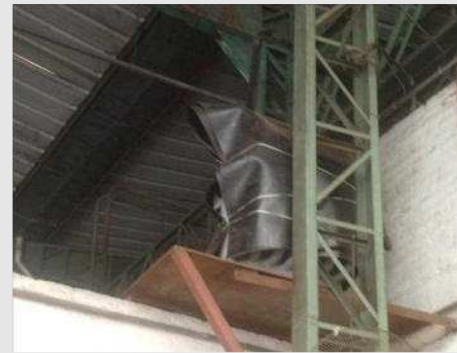
TRANSFORMADOR A ÓLEO TRIFASICO POT 45 KVA 380V | Item: 186 |
