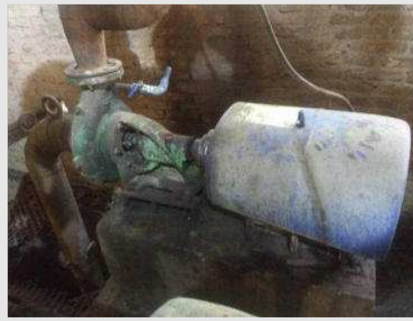
BOMBA CENTRÍFUGA MARCA IMBIL MOD ITAP 100/250 COM MOTOR DE 20 CV | Item: 8 |
