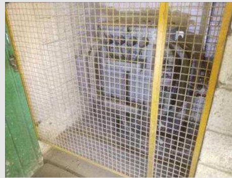
TRANSFORMADOR A ÓLEO TRIFASICO POT 75 KVA 380V | Item: 185 |
