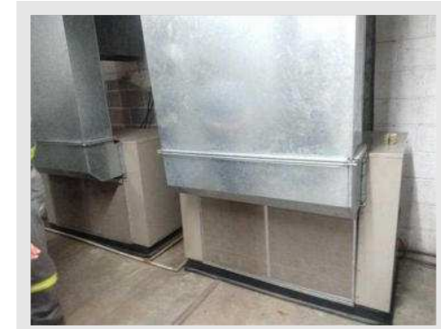
CENTRAL DE AR PARA CLP ELETRICA COM 2 CONDENSADORAS E 2 EVAPORADORAS MARCA. HITACHI MOD RAS1000AC | Item: 154 |
