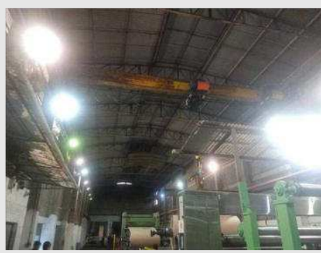
PONTE ROLANTE MARCA MUNCK VAO DE 10M CAO 6.3 TON | Item: 126 |
