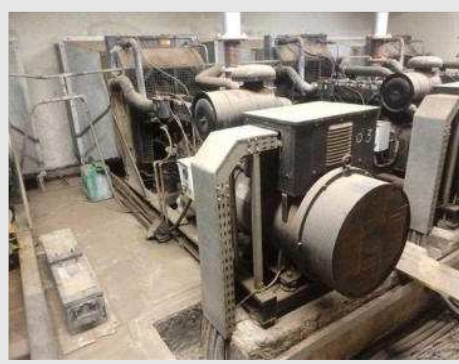
GRUPO GERADOR MARCA STEMAC POT 450 KVA | Item: 237 |
