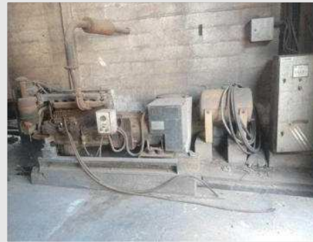
GRUPO GERADOR A MARCA STEMAC 80 KVA | Item: 174 |
