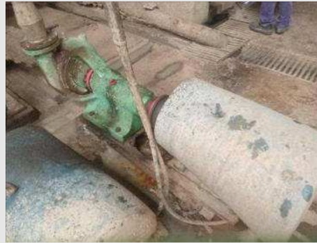
BOMBA CENTRÍFUGA EM AÇO INOX MARCA IMBIL MOD RAS 100/270 COM MOTOR DE 20 CV | Item: 47 |
