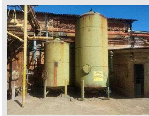
ETA MARCA FILTRAGUA CAP. 7,5 M 3 /H COMPOSTA DE: 1 TANQUE CILÍNDRICO DECANTADOR 1 FILTRO DE PRESSÃO 1 BOMBA DOSADORA | Item: 73 |
