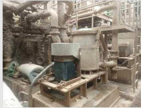
DEPURADOR MARCA VOITH MOD BA 400 COM MOTOR DE 75 CV | Item: 42 |
