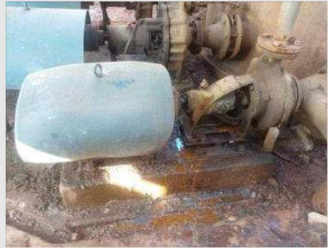
BOMBA CENTRÍFUGA MARCA IMBIL MOD 32/120 COM MOTOR DE 2CV | Item: 71 |
