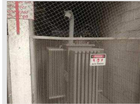
TRANSFORMADOR A ÓLEO TRIFÁSICO POT 1500 KVA 380V | Item: 152 |
