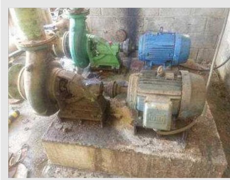
BOMBA CENTRÍFUGA MARCA IMBIL MOD 125/260 COM MOTOR DE 20 CV | Item: 1 |
