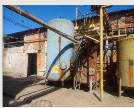
ETA MARCA FINTRAGUA CAP. 7,5 M 3 /H COMPOSTA DE: 1 TANQUE CILÍNDRICO DECANTADOR 1 FILTRO DE PRESSÃO 1 BOMBA DOSADORA | Item: 74 |
