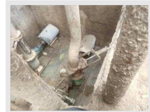
BOMBA CENTRÍFUGA MARCA IMBIL MOD ITAP 250/290 COM MOTOR DE 30 CV | Item: 82 |
