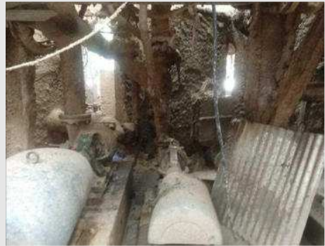
TANQUE CILÍNDRICO EM FIBRA (AGUA) DIAM 250X200 CM COM BOMBA CENTRÍFUGA MARCA IMBIL MOD RAS 100/270 COM MOTOR DE 25 CV | Item: 53 |
