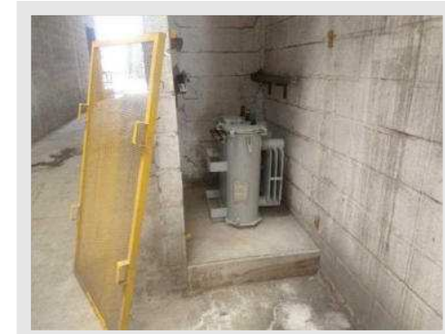
TRANSFORMADOR A ÓLEO TRIFASICO POT 45 KVA 380V | Item: 184 |
