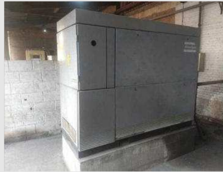
COMPRESSOR DE AR MARCA ATLAS COPCO MOD GA75 | Item: 209 |
