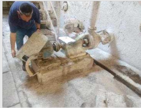
BOMBA CENTRÍFUGA MARCA IMBIL MOD 100/270 COM MOTOR DE 20 CV (TANQUE DO ENGROSSADOR, ALVENARIA) | Item: 108 |
