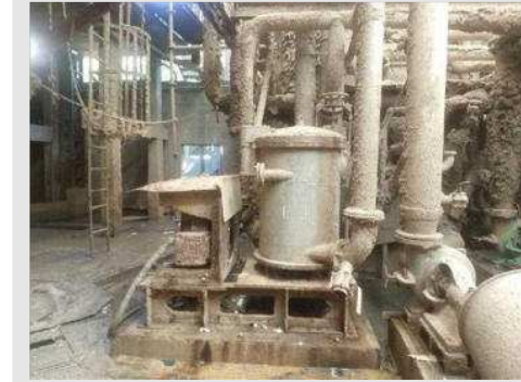
DEPURADOR MARCA VOITH MOD BA 400 COM MOTOR DE 75 CV | Item: 43 |
