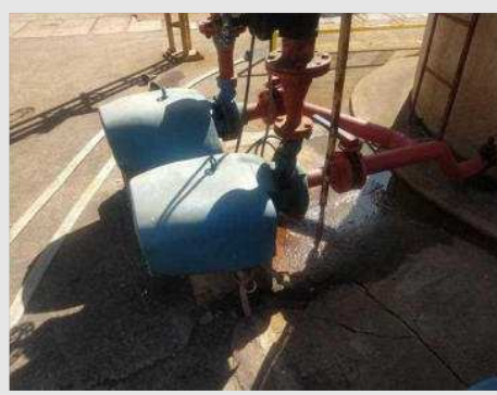
BOMBA CENTRÍFUGA MARCA KSB COM MOTOR DE 20 CV | Item: 63 |
