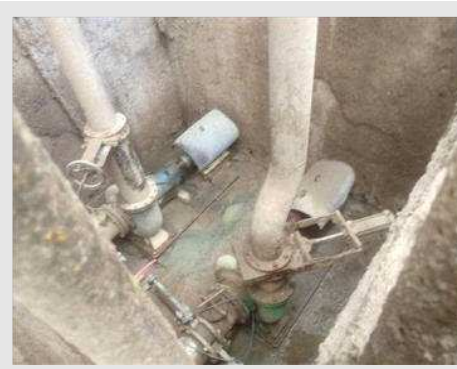
BOMBA CENTRÍFUGA MARCA IMBIL MOD ITAP 250/290 COM MOTOR DE 30 CV | Item: 81 |
