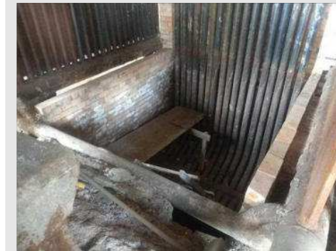
CALDEIRA II A LENHA CAP 7000KGF/H MARCA ATA MOD ATA29LP ANO 1995 COM SISTEMA DE EXAUSTÃO E PAINEL | Item: 171 |
