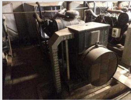
GRUPO GERADOR MARCA STEMAC POT 450 KVA | Item: 239 |
