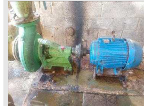
BOMBA CENTRÍFUGA MARCA IMBIL MOD 125/260 COM MOTOR DE 20 CV | Item: 67 |
