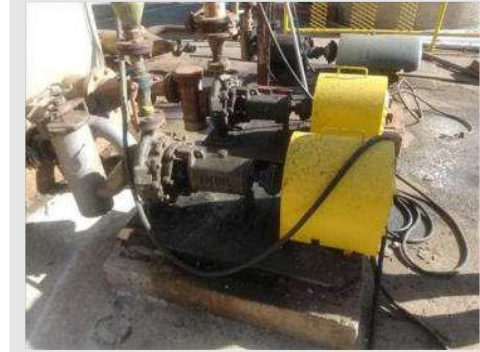
BOMBA CENTRÍFUGA MARCA IMBIL MOD INI 40/260 COM MOTOR DE 5 CV | Item: 61 |
