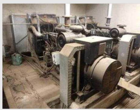
GRUPO GERADOR MARCA STEMAC POT 450 KVA | Item: 236 |
