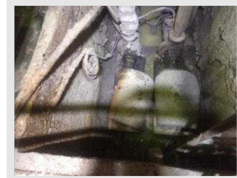
DEPURADOR COM MOTOR DE 25 CV E BOMBA CENTRÍFUGA MARCA IMBIL MOD BMI6X4X10 COM MOTOR DE 30 CV | Item: 124 |
