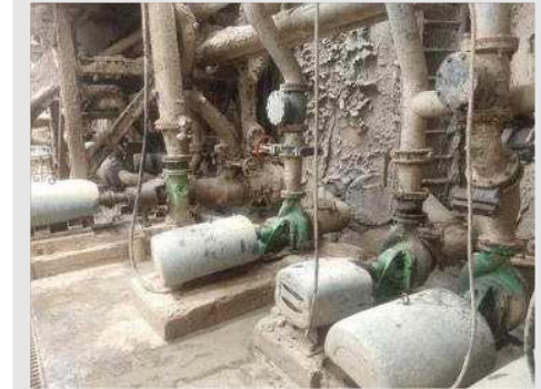
TANQUE CILÍNDRICO (AGUA 2) EM AÇO CARBONO DIAM 350X350 CM COM 1 BOMBA CENTRÍFUGA MARCA VOITH MOD L 20/25 100 CV, 1 BOMBA CENTRÍF. MARCA IMBIL MOD INIO 80/400 E 3 BOMBAS CENTRÍF. IMBIL MOD ITAP 125/200 | Item: 56 |
