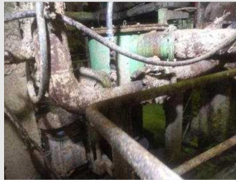
DEPURADOR COM MOTOR DE 25 CV E BOMBA CENTRÍFUGA MARCA IMBIL MOD BMI6X4X10 COM MOTOR DE 30 CV | Item: 124 |
