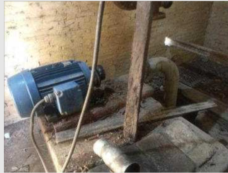
BOMBA CENTRÍFUGA MARCA IMBIL MOD ITAP 100/250 COM MOTOR DE 20 CV | Item: 16 |
