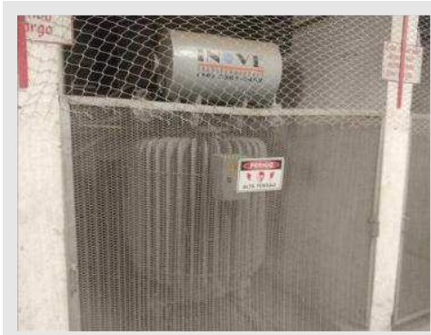
TRANSFORMADOR A ÓLEO TRIFASICO POT 1500 KVA 380V | Item: 182 |
