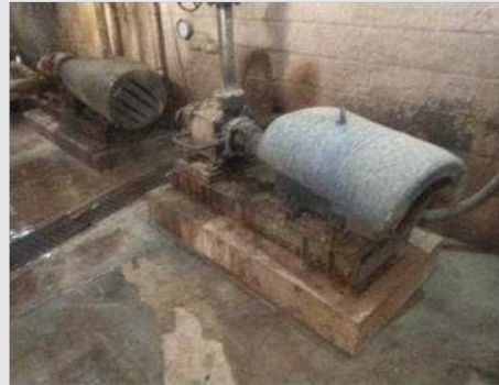
TANQUE CILÍNDRICO EM AÇO CARBONO DIAM 150X200 CM COM 2 BOMBAS CENTRÍFUGAS EM AÇO INOX MULTIESTÁGIO MARCA KSB MOD MULTITECH 65/3 COM MOTOR DE 75 CV | Item: 22 |
