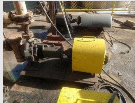
BOMBA CENTRÍFUGA MARCA IMBIL MOD INI 40/260 COM MOTOR DE 5CV | Item: 65 |
