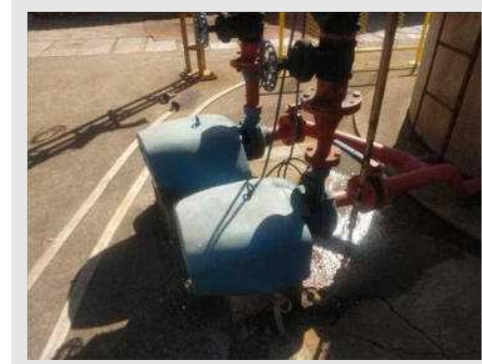
BOMBA CENTRÍFUGA MARCA KSB COM MOTOR DE 20 CV | Item: 64 |
