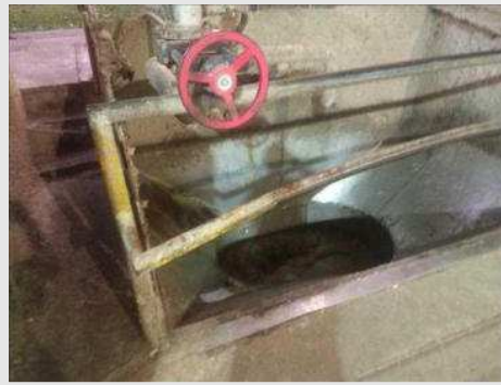
HIDRINHO COM AGITADOR COM BOMBA CENTRÍFUGA MARCA IMBIL MOD RT 270 COM MOTOR DE 25 CV | Item: 128 |
