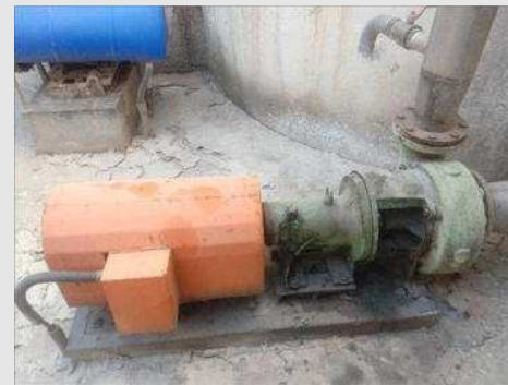
BOMBA CENTRÍFUGA MARCA IMBIL MOD 100270 COM MOTOR DE 20 CV | Item: 102 |
