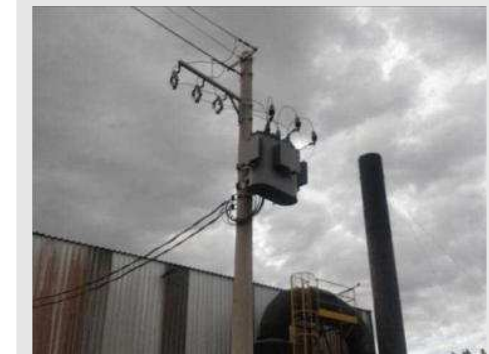
TRANSFORMADOR A ÓLEO POT 150 KVA 380V (CALDEIRA) | Item: 225 |
