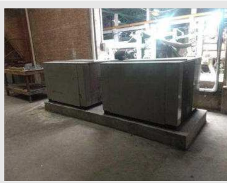
CENTRAL DE AR PARA CLP ELETRICA COM 2 CONDENSADORAS E 2 EVAPORADORAS MARCA. HITACHI MOD RAS1000AC | Item: 154 |
