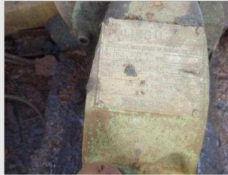
BOMBA CENTRÍFUGA MARCA IMBIL MOD 32/120 COM MOTOR DE 2CV | Item: 71 |
