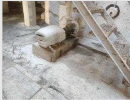
BOMBA CENTRÍFUGA MARCA IMBIL MOD 100270 COM MOTOR DE 20 CV (TANQUE DO ENGROSSADOR, ALVENARIA) | Item: 109 |
