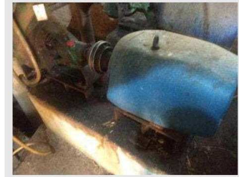
BOMBA CENTRÍFUGA MARCA IMBIL MOD ITAP 100/250 COM MOTOR DE 20 CV | Item: 9 |
