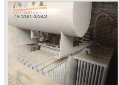
TRANSFORMADOR A ÓLEO TRIFASICO POT 1500 KVA 380V | Item: 181 |
