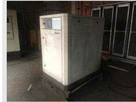
COMPRESSOR DE AR MARCA FS CURTIS MOD SEM 50-8 CAP 63 M³/MIN | Item: 210 |
