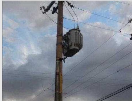
TRANSFORMADOR A ÓLEO TRIFASICO POT 225 KVA 380V | Item: 244 |
