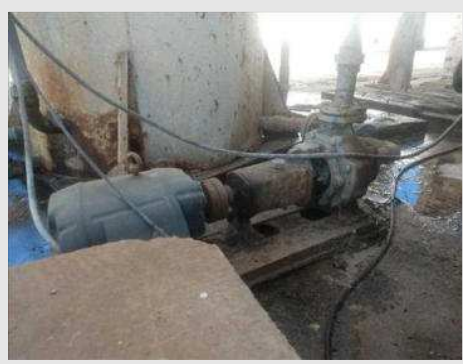
BOMBA CENTRÍFUGA MARCA IMBIL MOD INIK 5200 COM MOTOR DE 7.5 CV | Item: 68 |
