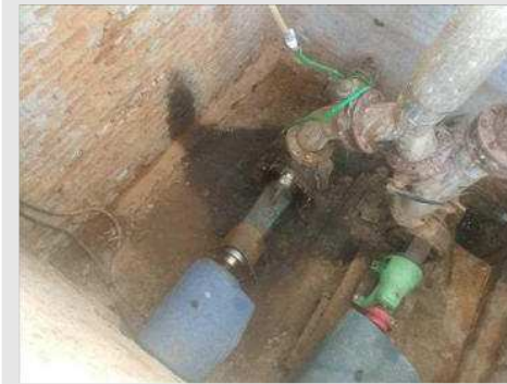
BOMBA CENTRÍFUGA MARCA IMBIL MOD 126/260 COM MOTOR DE 25CV | Item: 5 |
