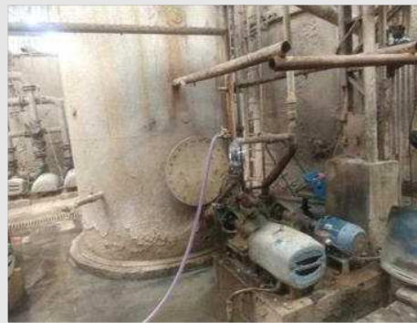
TANQUE CILÍNDRICO EM AÇO CARBONO (CONTRA CAPA) DIAM 200X350 CM COM 2 BOMBAS CENTRÍFUGAS MARCA IMBIL MOD RT 50/180 COM MOTOR DE 15 CV | Item: 78 |
