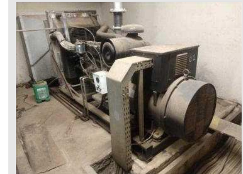
GRUPO GERADOR MARCA STEMAC POT 450 KVA | Item: 235 |
