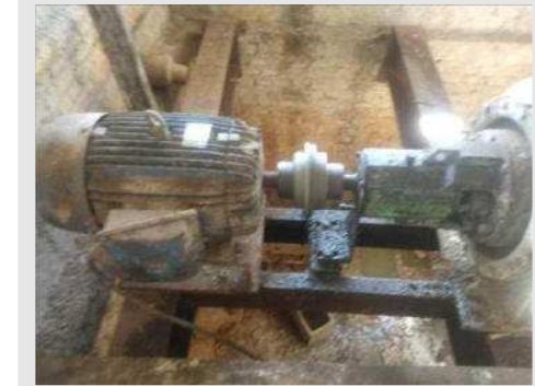
BOMBA CENTRÍFUGA MARCA MULTISTEEL MOD 100/400 COM MOTOR DE 20 CV | Item: 6 |
