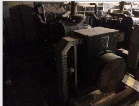
GRUPO GERADOR MARCA STEMAC POT 450 KVA | Item: 240 |
