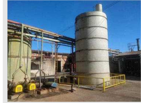
TANQUE DE ÁGUA INCÊNDIO CILÍNDRICO EM FIBRA DIAM 220X600 CAP 50 M³ | Item: 30 |
