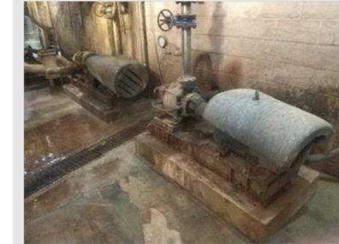
TANQUE CILÍNDRICO EM AÇO CARBONO DIAM 150X200 CM COM 2 BOMBAS CENTRÍFUGAS EM AÇO INOX MULTIESTÁGIO MARCA KSB MOD MULTITECH 65/3 COM MOTOR DE 75 CV | Item: 22 |
