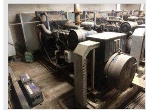
GRUPO GERADOR MARCA STEMAC POT 450 KVA | Item: 238 |
