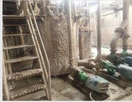
TANQUE EM AÇO CARBONO (REJEITO) DIAM 150X250 CM COM 2 BOMBAS CENTRÍFUGAS MARCA IMBIL E MOTORES DE 10 CV | Item: 51 |
