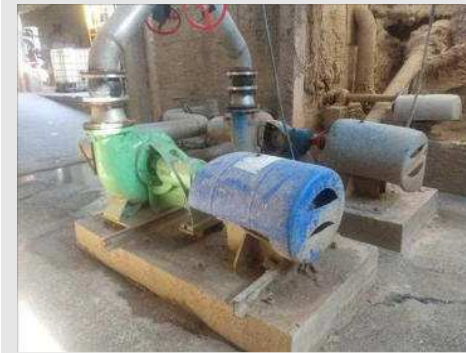
BOMBA CENTRÍFUGA MARCA IMBIL MOD ITAP 250/290 COM MOTOR DE 30 CV | Item: 83 |
