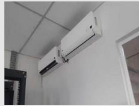
APARELHO DE AR CONDICIONADO SPLIT MARCA CARRIER CAP 9 000 BTU'S | Item: 459 |
