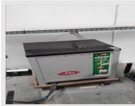
CARREGADOR DE BATERIA TRACIONARIA MARCA JLW MOD. JK-24/40 NS.101279 (SP-LOG-065) | Item: 15 |
