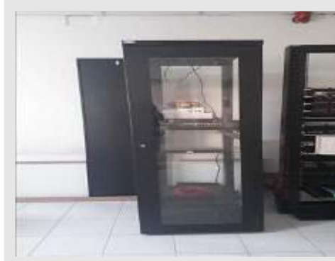
RACK METALICO P/ EQUIPAMENTOS DE INFORMÁTICA MARCA CENTRAL CABOS C/ 1 PORTA DIM. 0,60X0,85X2,0 M | Item: 466 |
