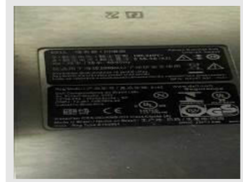
SERVIDOR DE REDE MARCA DELL MOD. POWEREDGE R620 TIPO E16S001 NS. J38TJA00 C/ PROCESSADOR INTEL XEON | Item: 474 |
