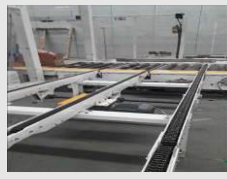
ESTEIRA TRANSPORTADORA MOTORIZADO MARCA FABRIMA TIPO CORRENTE MOD. 5X03020000 DIM. 1,10X2,10 M | Item: 64 |
