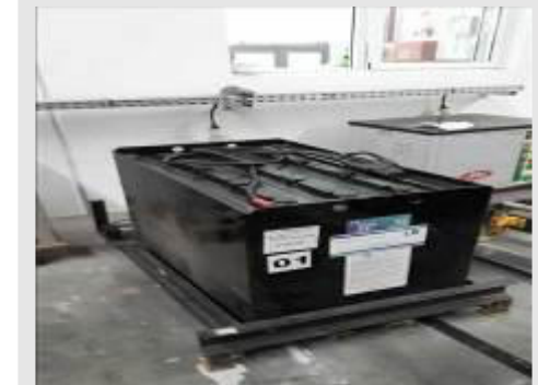
BATERIA TRACIONARIA MARCA LB BATERIAS TIPO 6-PZS720 NS. 6577/18-01 CAP. 720AH/24V 12 ELEMENTOS | Item: 14 |
