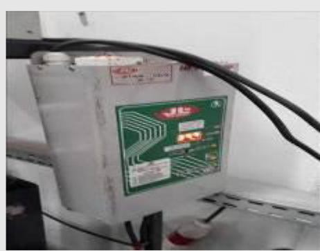
CARREGADOR DE BATERIA TRACIONARIA MARCA JLW MOD. HFT 24/40 NS. 108553 | Item: 8 |
