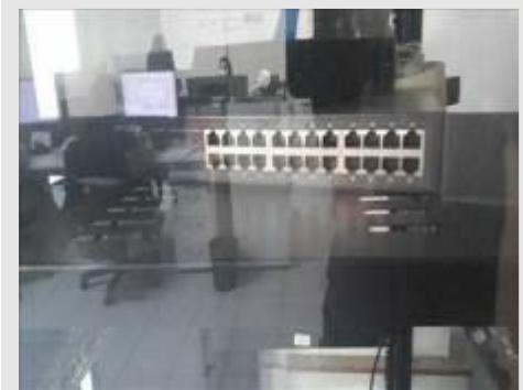
SWITCH MARCA TP-LINK MOD. TL-SG1024D C/ 24 PORTAS | Item: 468 |
