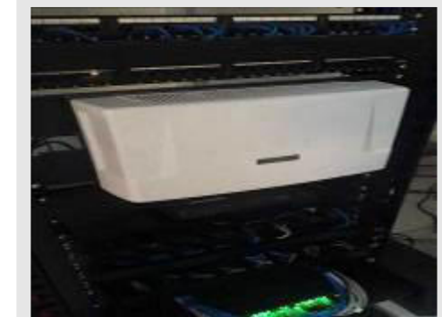
CENTRAL TELEFONICA MARCA ITELBRAS MOD. IMPACTA | Item: 470 |
