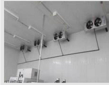
CONJ DE 4 EVAPORADORES DUPLO MARCA FLEXCOLD (SALA CLIMATIZADA SO-11L) | Item: 317 |
