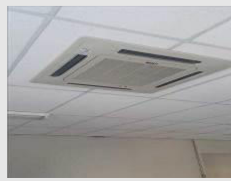
CENTRAL DE AR CONDICIONADO DE TETO MARCA YORK JOHNSONS CONTROLS | Item: 457 |
