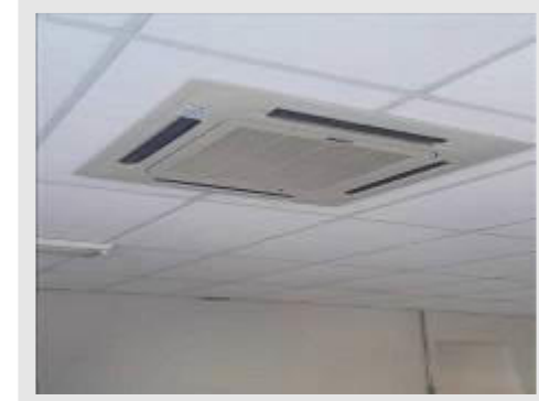
CENTRAL DE AR CONDICIONADO DE TETO MARCA YORK JOHNSONS CONTROLS | Item: 457 |
