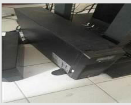
NO BREAK MARCA APC MOD. SRT6KRMXLI POT. 6 KVA , 220/240V | Item: 472 |
