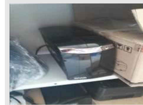
NO BREAK MARCA SMS MOD. STATION 1200 | Item: 422 |
